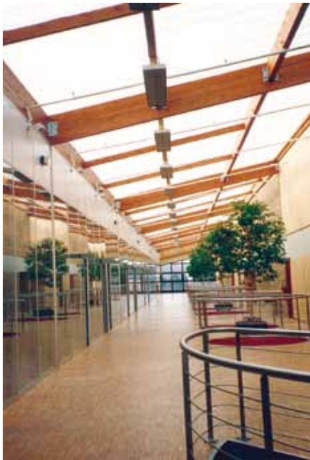
Flure sind sehr schwer zu beheizen, aber der an der Decke montierte EZ100 heizt dort, wo die Wärme benötigt wird.
